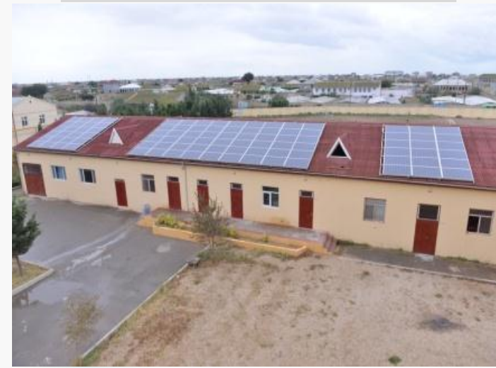
Детский дом в Туркане (25 кВт эл.)
